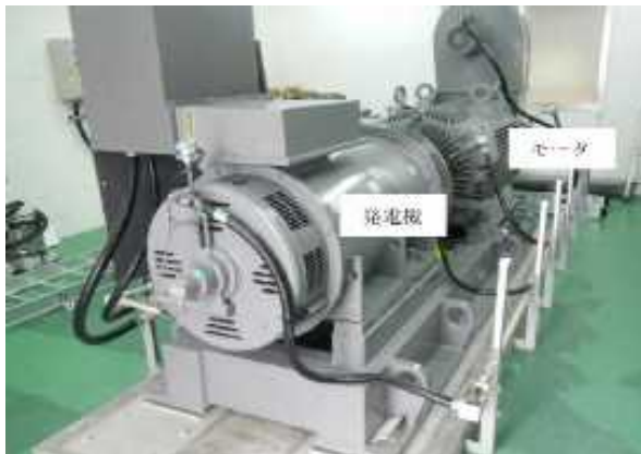
左上：波照間可倒式風力発電設備、左下：MGセット 出典) 沖縄電力株式会社WEBサイト
