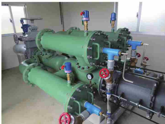
水利施設整備事業 読谷中部地区 H30完了 フィルター施設
