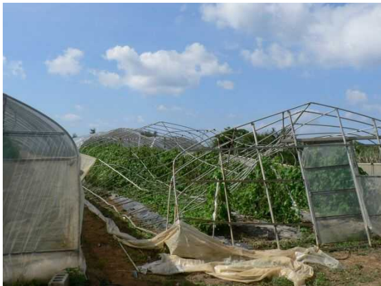
倒壊したビニールハウス
