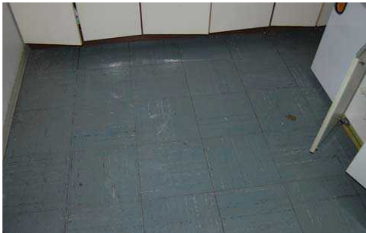
石綿含有成形板(床材 Pタイル)
