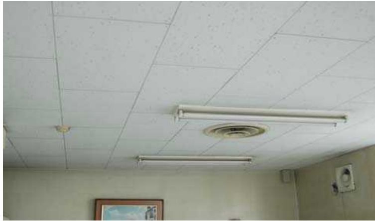
石綿含有成形板(天井材)
