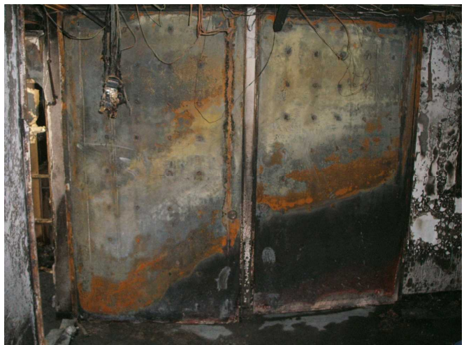
閉まらなかった1階階段室の防火戸 (国交省説明資料から引用)
