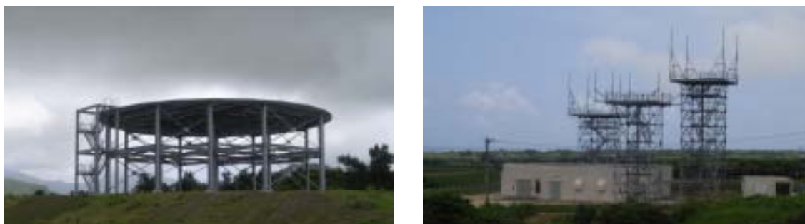
図 2.12.1 現況写真（左：VOR / DME 施設、右：T S R 施設 平成 24 年 5 月）
