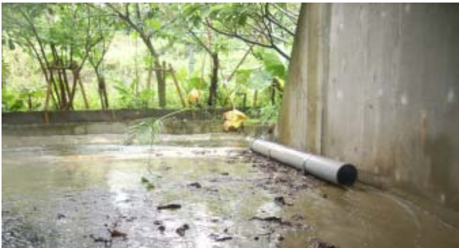
雨水の流入状況（平成 23 年 4 月）
