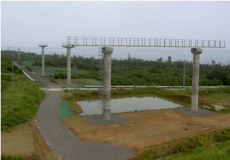
図 1.9.2 簡易式進入灯設置状況
