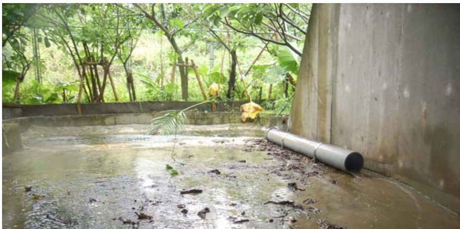
雨水の流入状況（平成 23 年 4 月）
