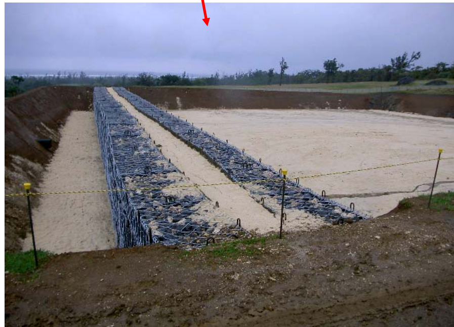
(ろ過沈殿処理池)
