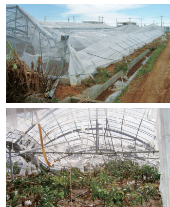
台風による園芸施設の被害
