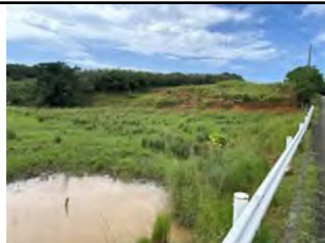
段差のある草地のがけ崩れと滞水している窪地
