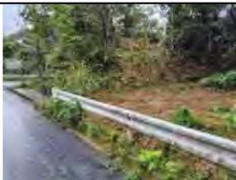
ア. 法面崩壊カ所
