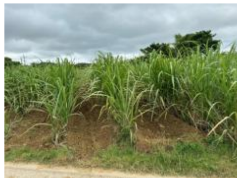
対策未実施例 地点No.8 1
