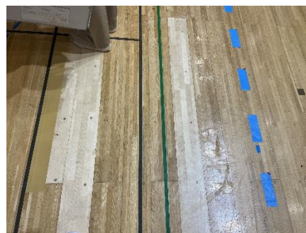
床面劣化あり（雨漏りが影響）
