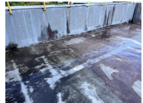
管理棟2階の塗装劣化
