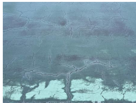
バンクのひび割れ
