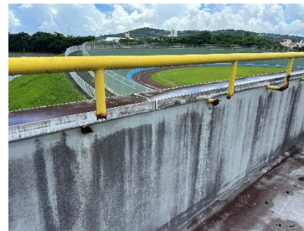
管理棟2階の手すり劣化
