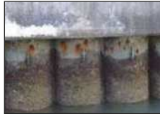
腐食が進行した 鋼管式防波堤
