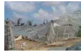
園芸施設の被害
