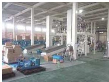
農産物集出荷貯蔵施設(ピーマン)
