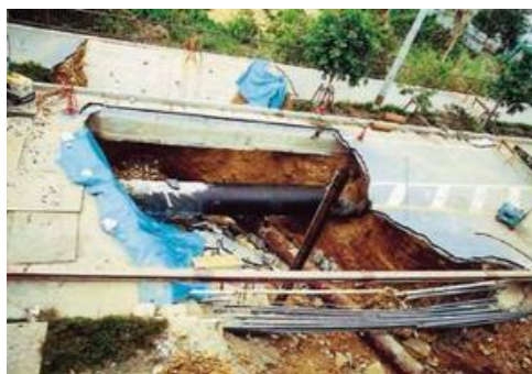
平成 13 年台風 16 号による県道 10 号線の被害状況
