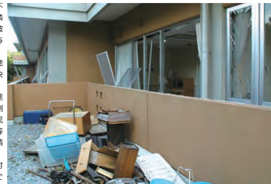
爆発で窓ガラスが割れた老人ホームの建物(平成21年1月15日沖縄タイムス)
