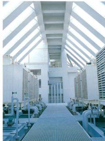
↓ 屋上の空調等設備
