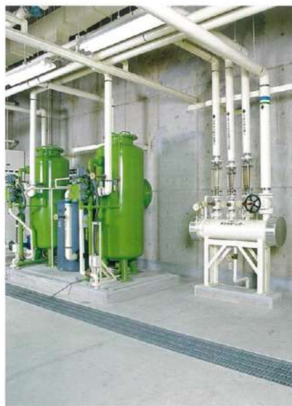
↑ 雨水と地下水使用で節水
