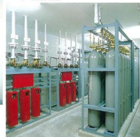
↓ ハロン消火設備
