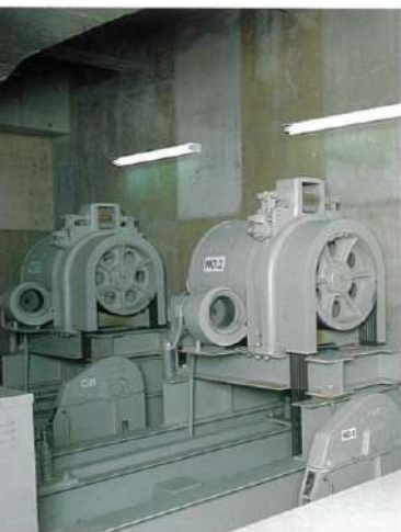
↑ エレベーター機械室
