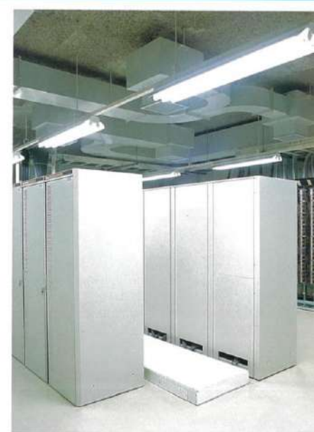
↑電話交換機室
