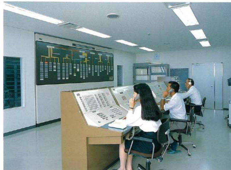
↑ 防災行政無線室
