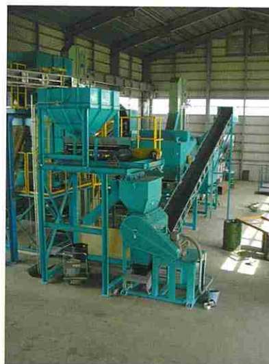
図3 パイロットプラント
