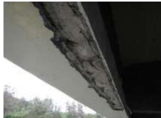
写真4 臨港道路(橋梁部)床版コンクリート剥離、鉄筋露出状況
