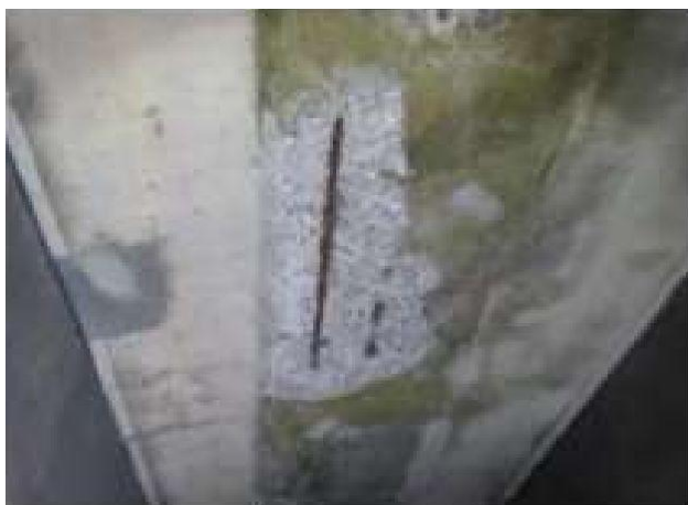
写真3 臨港道路(橋梁部)床版のコンクリート剥離、鉄筋露出状況
