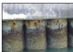
腐食が進行した 鋼管式防波堤
