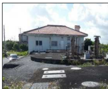
集落排水施設の処理場
