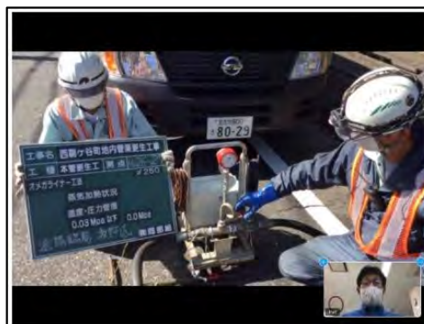
【立会状況画面（現場側）】
