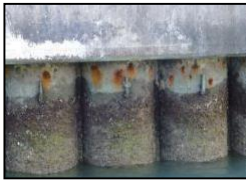
腐食が進行した鋼管式防波
