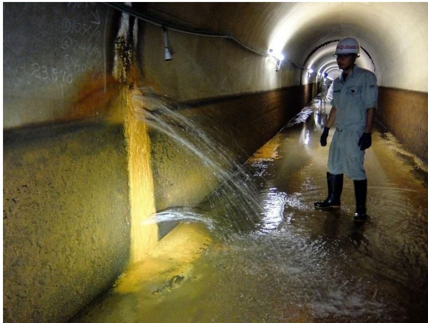
老朽化状況（漏水）
