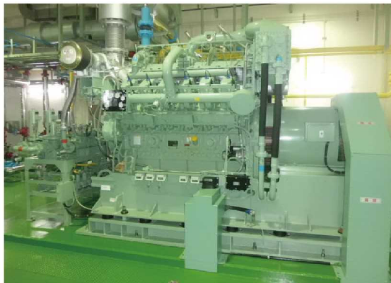
消化ガス発電機
