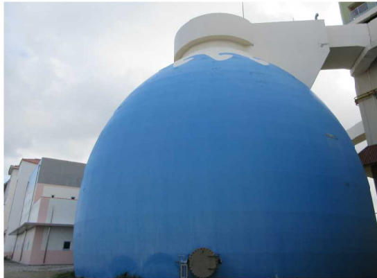
汚泥消化タンク
