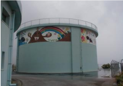
ファームポンド (ダムや貯水池からの水を貯めておくタンク)
