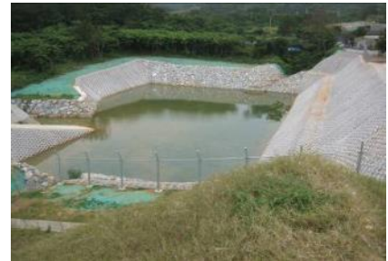
沈砂池 (排水の流速を抑えて 赤土を沈殿させる施設)
