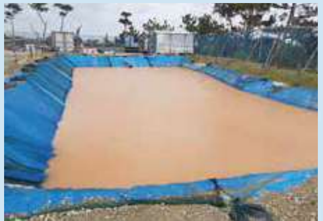
だくすいさいしゅうじょうり たいさくそうち しぜんちんでんち 濁水最終処理対策装置(自然沈殿池)
