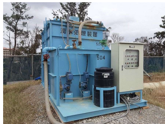
写真 濁水凝集処理装置
