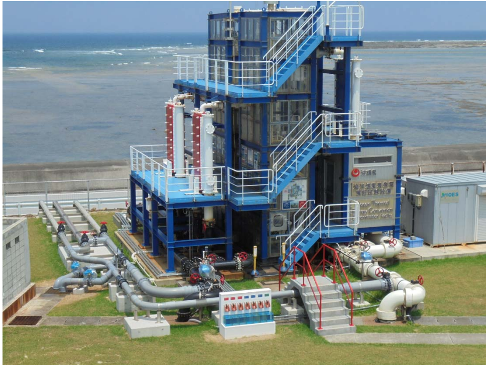
図 3-6 竣工時写真：発電後海水配管および温度表示小型水槽
