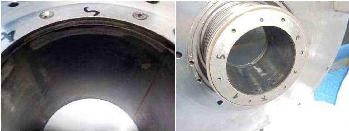
図 2-82 ラジアル軸受（前部）左：DSS 前、右：DSS 後 擦痕の程度は DSS 後の方が若干激しい ラジアル軸受は、2016 年 3 月の点検後に新品に交換している
