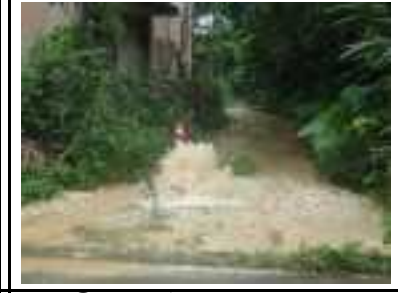
⑭ 水が噴き出す箇所 (濁水流出)
