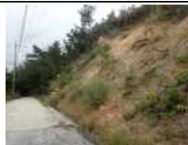
⑦ 裸地目立ち赤土等流出の可能性のある山部法面
