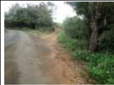
④ 農地から道路へ赤土等の若干の流出痕状況
