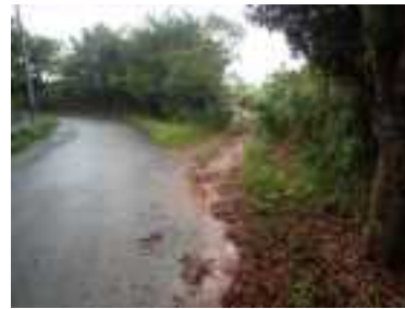
④ 農地から道路へ赤土等の流出状況
