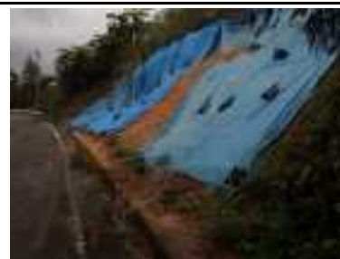
⑥ 土砂崩れ箇所から側溝へ赤土等の流出状況
