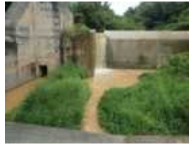
③ 地点②の上流にある砂防ダムの状況(濁り有り)
