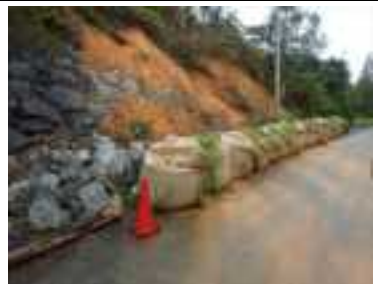
⑥ 土砂崩れ箇所からの赤土等の流出痕状況
