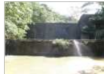
③ 砂防ダム
