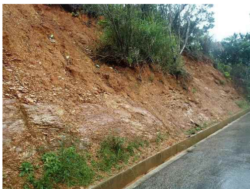
地点④ がけ崩れと側溝に堆積した赤土
