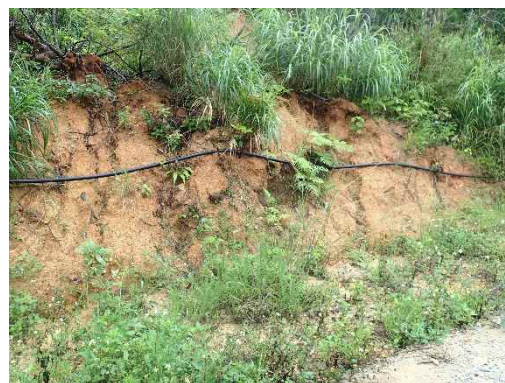
地点⑥ がけ崩れ後の状況(変化無し)
