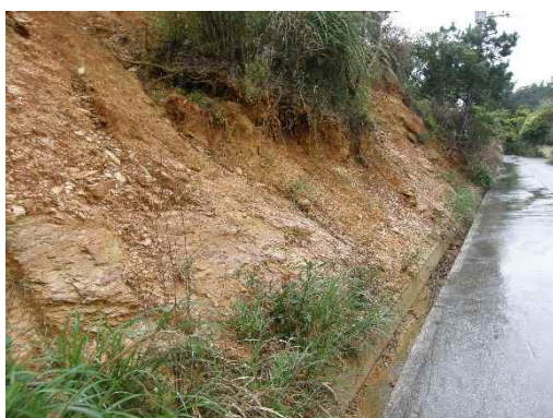
地点④ がけ崩れと側溝に堆積した赤土
