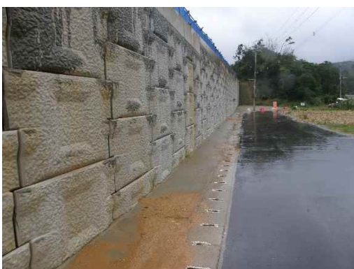
地点② 法面から赤土が流出
