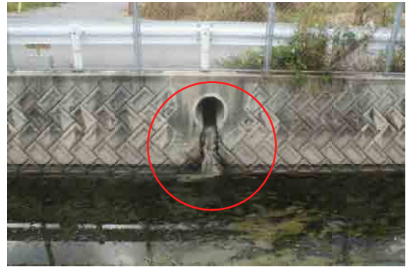
上流部の排水口から流入する生活雑排水等
