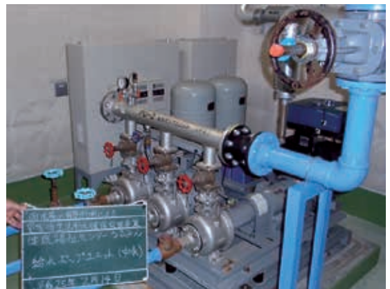
雨水用給水ポンプユニット
