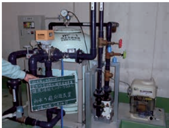
雨水ろ過処理装置及び薬注装置
