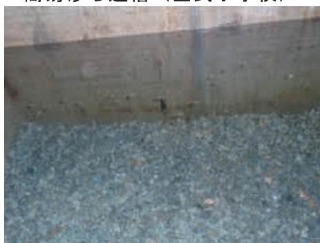
簡易砂ろ過槽（金武小学校）
