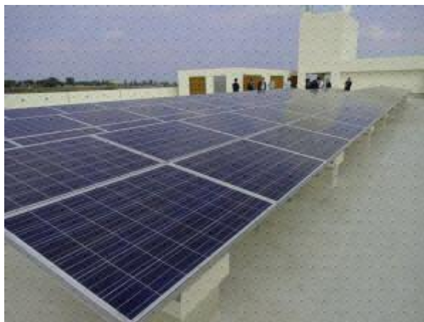
7 図 4-7 伊江小学校に設置された太陽光パネル
