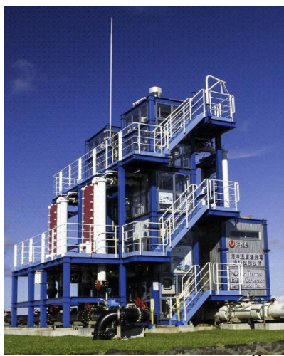
図 4-2 久米島に設置した海洋温度差発電（OTEC）実証試験設備
