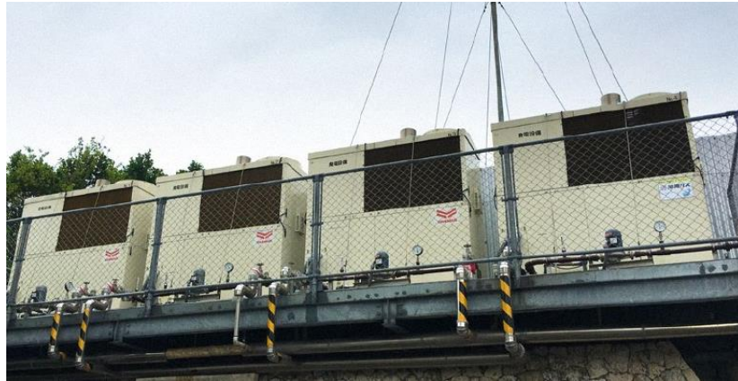
3 図 4-3 ローヂールホテル&スパタワー那覇におけるガスエンジン・コージェネレーション
