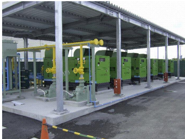
11 図 4-4 具志川浄化センターに導入したバイオマス発電設備
