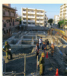
那覇市内の住宅地で建物の下に埋まっていた旧日本軍製50kg焼弾が発見された建設工事現場（平成30年12月）
