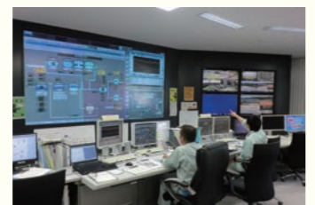
中央監視室(石川)
