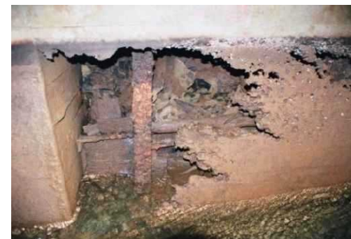
導水路内部の劣化
