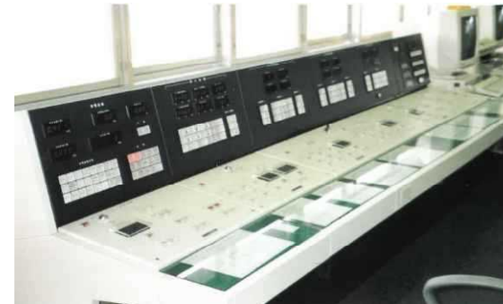
ダム管理用制御処理設備
