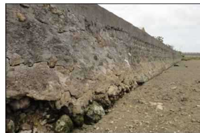
護岸基礎が老朽化により崩壊
