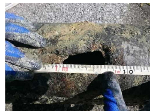
配水管の腐食
