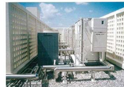
氷蓄熱槽と室外機
