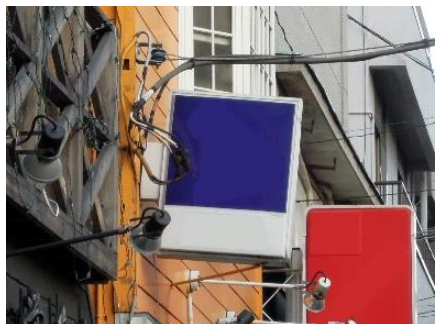
屋外広告物本体の傾き
