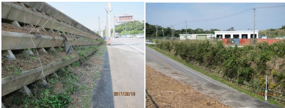
D-① 構造物を伴う法面での植栽物が消失し雑草が繁茂している様子
