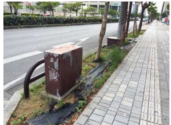
植樹柵内に配電盤、道路照明等の道路付属物が配置されている⇒
