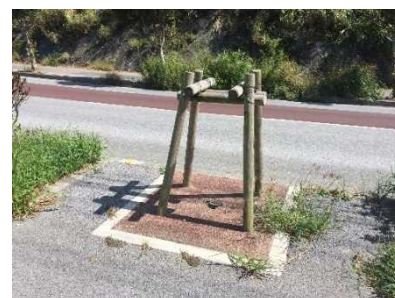
高木が欠損し支柱のみ残存している状態
