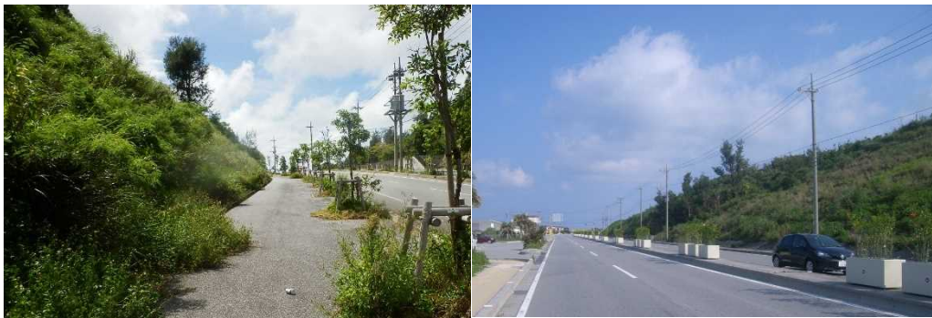
C-① 構造物を伴わない法面での雑草雑木の繁茂
