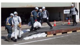
軽量段差修正材による橋梁段差補修 （首都高速道路株式会社）
