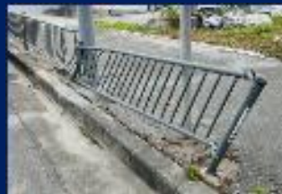
③ガードレール・標識等の損傷
