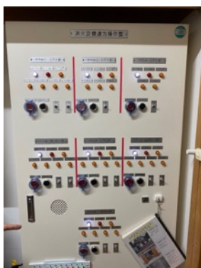
写真 5.13：消火設備遠方操作盤
