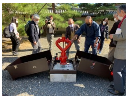
写真 5.18：消火栓付き放水銃
