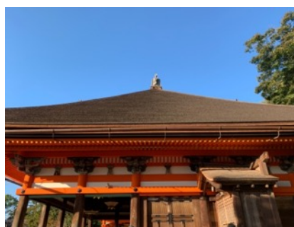
写真 5.26：屋根に設置されたドレンチャー
