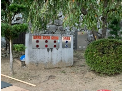
写真 5.9: ニノ丸の連結送水管
