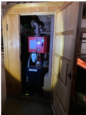
写真 5.5：バルブユニット
