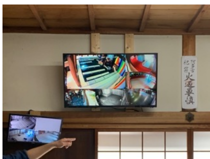
写真 5.15：本坊事務室内の監視カメラモニター
