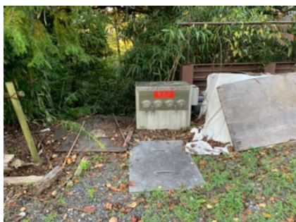
写真 5.27：防火水槽と送水口
