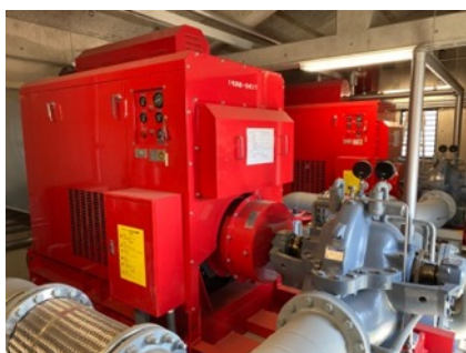
写真 5.17：加圧エンジン及びポンプ
