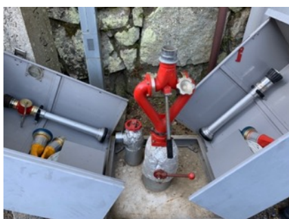
写真 5.25：屋外消火栓付き放水銃
