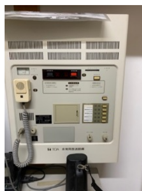
写真 5.14：非常用放送設備
