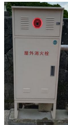
⑬屋外消火栓
