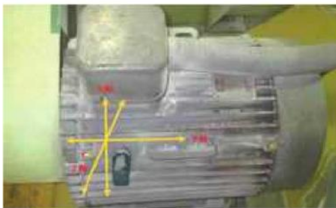
排気ファンにセンサを設置した状況
